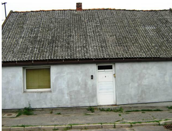
Rys. 7. Pokrycie dachowe ocenione w II stopniu pilności.
