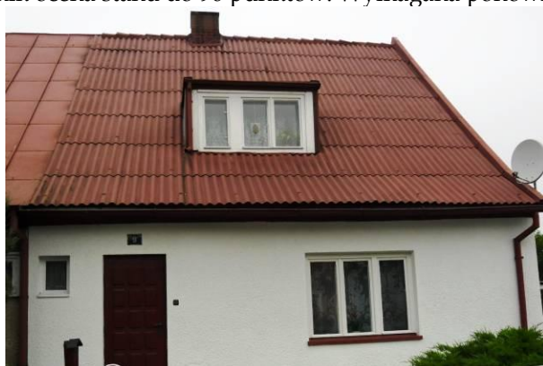
Rys. 6. Pokrycie dachowe ocenione w III stopniu pilności.
