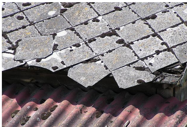
Rys. 8. Pokrycie dachowe ocenione w I stopniu pilności.
